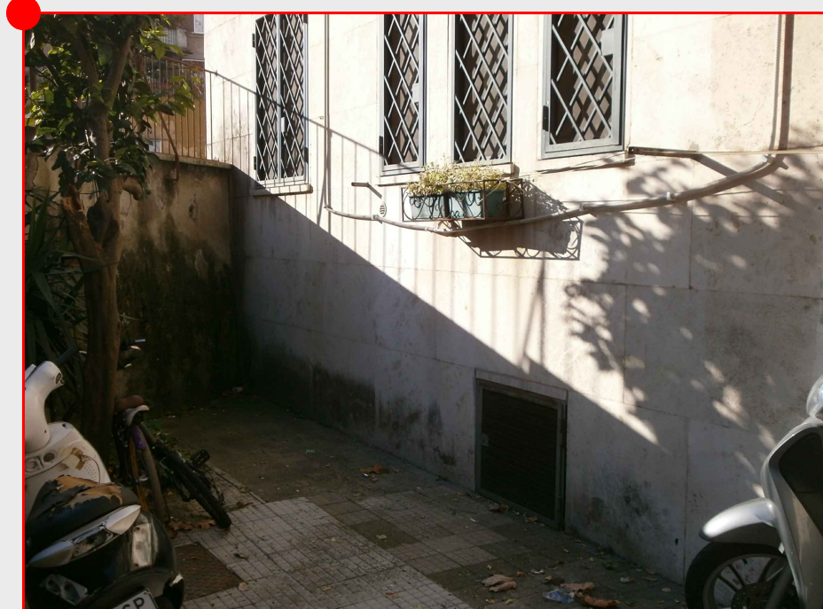
L'apertura per la ventilazione, in comunicazione con l'intercapedine presente sotto il piano rialzato e chiusa da un graticcio metallico, è una ulteriore via d'uscita per le dispersioni termiche dell'edificio dato che il solaio del piano rialzato non è isolato termicamente come tutti gli elementi dell'involucro edilizio (si veda la tavola 7).
