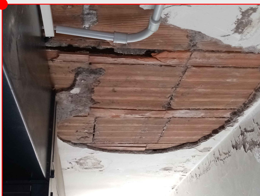
Intradosso del solaio di copertura del corpo scala: sono visibili il distacco e la perdita dell'intonaco oltre che lo sfondellamento del travetto: sono il punto di arrivo del deterioramento dello strato di finitura, iniziato a causa delle infiltrazioni di acqua nel solaio di copertura o, più probabilmente, per gli effetti della condensa interstiziale.
